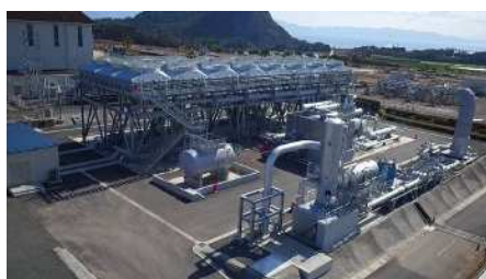
山川バイナリー発電所
