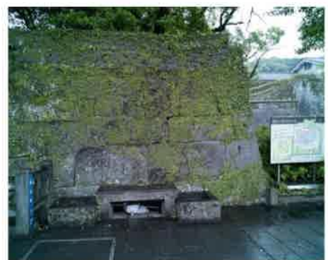
N001 面植物の繁茂
