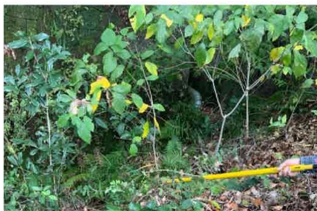
H021 面の背面に自生した植物
