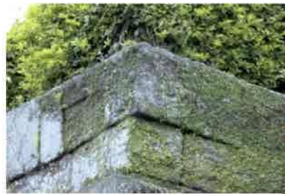
植根より飛び出した石塀
