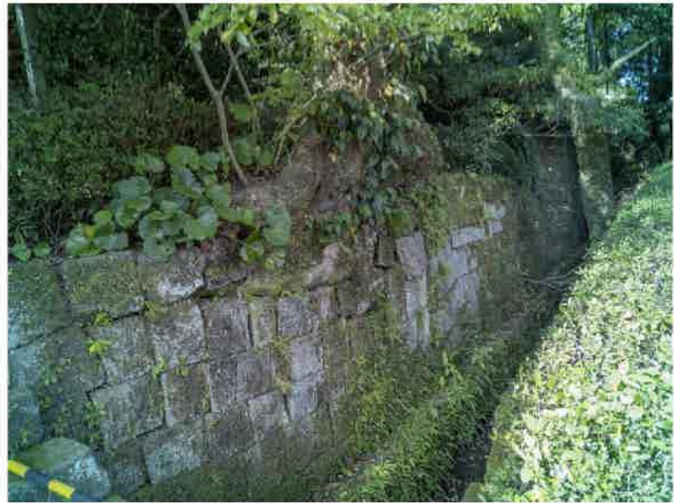
H022 面樹根の浸食、孕み
