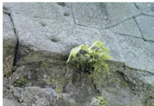
石材の損傷箇所での植物の繁茂
