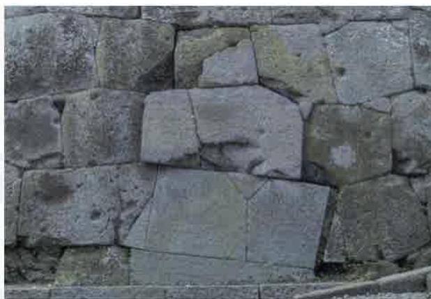
石材の補修箇所
