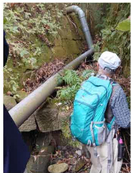
H001 面のパイプ
