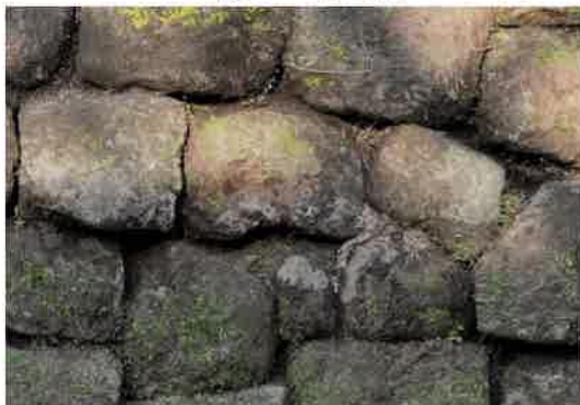
石材の風化劣化
