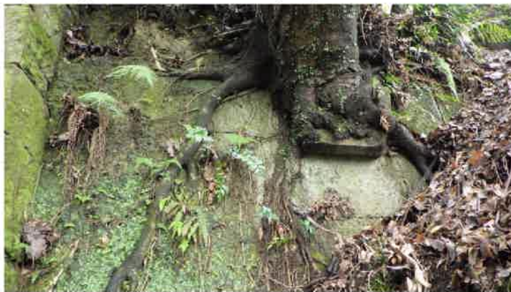
樹根による飛び出し
