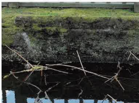
コケの繁茂（目地が見えない）
