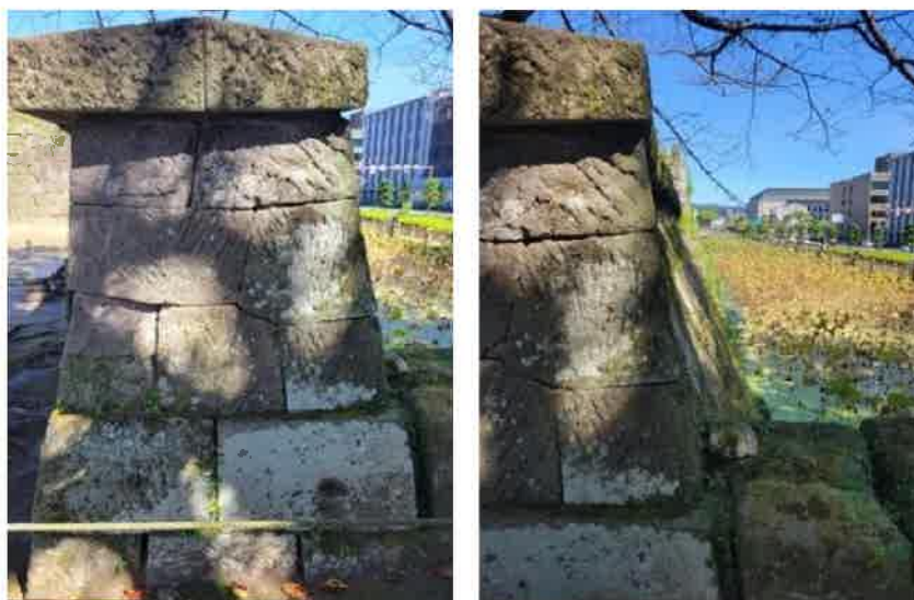
H035 を側面から見た写真 石塀の倒れ込み
