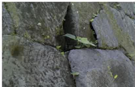
石材の補修箇所での植物の繁茂
