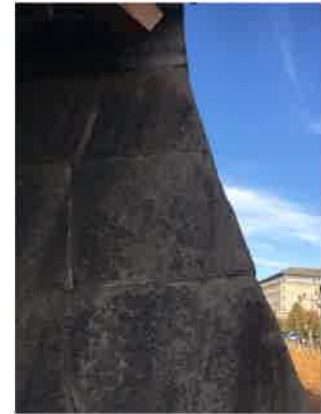
隅角の破断面
