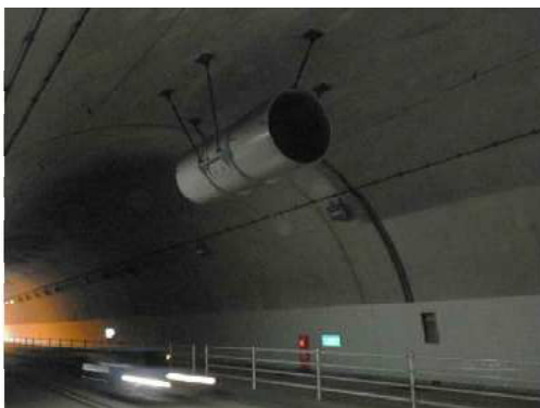
【ジェットファン(国道58号和光トンネル)】
