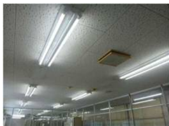
【事務所内 LED 照明】
