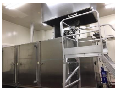
蒸気炊飯設備
