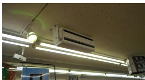
LED化・省エネ設備(ファン)
