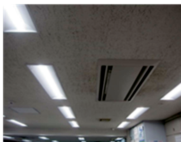
照明の LED 化（事務室）
