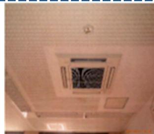
高効率空調設備の更新
