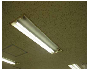
LED 照明の導入 (1 灯のみへの間引き)
