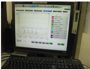
電力監視システム
