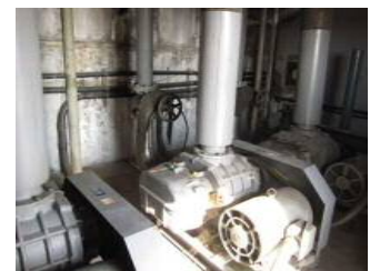
ブロアーの更新による 稼働台数の削減
