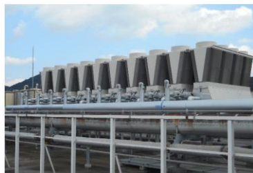
高効率モジュールチラー
