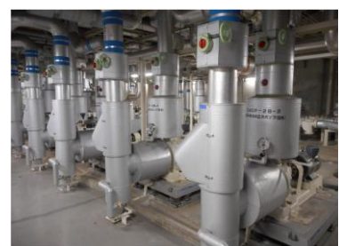
空調ポンプのインバータ化
