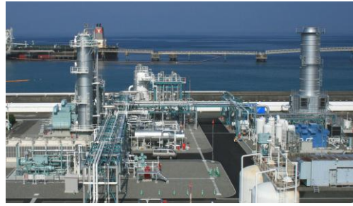
TVR 設備(タンカー排出ガス処理設備)
