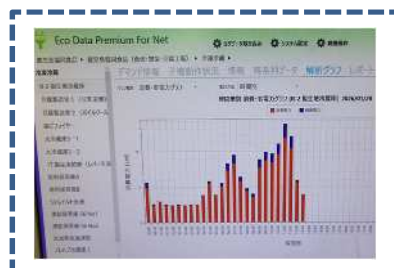
【③コンプレッサー制御監視画面】
