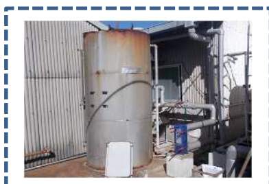
【②ボイラー廃熱回収システム】
