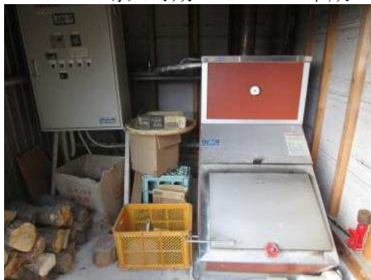
【バイオマス薪ボイラー】
