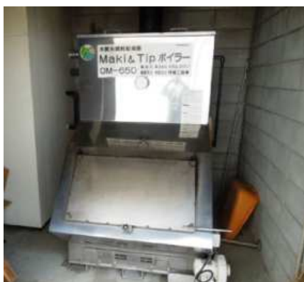
【バイオマス薪ボイラー】
