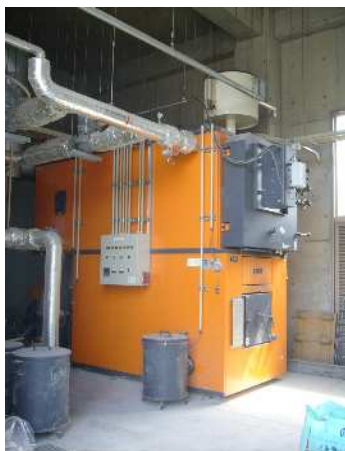
【木質バイオマスチップボイラー】
