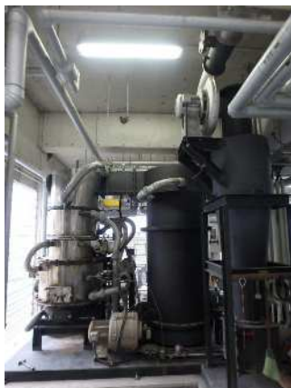
【木質バイオマス (チップ) ボイラー】
