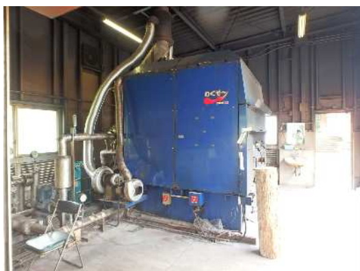
【木質バイオマス（薪）ボイラー】
