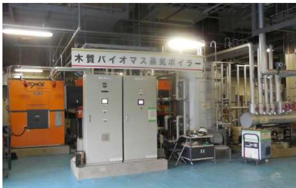
【木質バイオマスチップボイラー】
