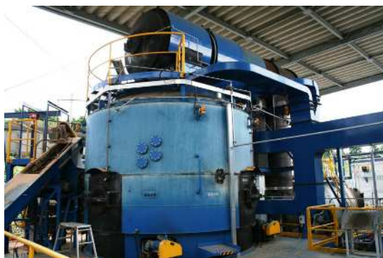
【木質バイオマスボイラー】
