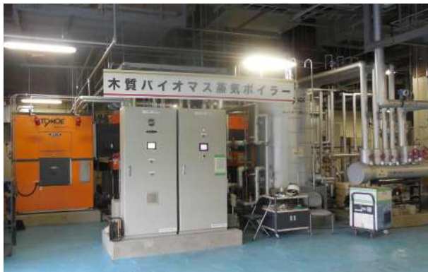
【木質バイオマスチップボイラー】
