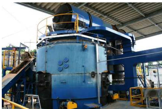
【木質バイオマスボイラー】
