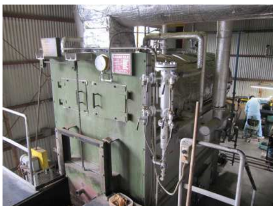
【木質バイオマスチップボイラー】
