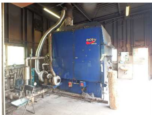
【木質バイオマス（薪）ボイラー】
