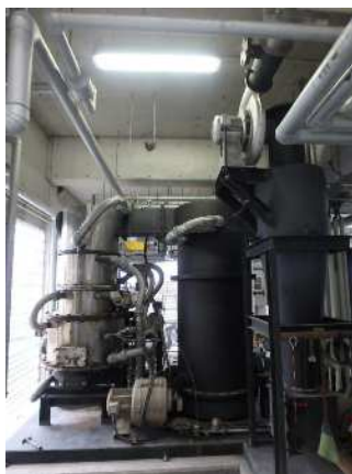
【木質バイオマス(チップ)ボイラー】
