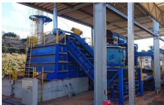
【木質バイオマスボイラー】
