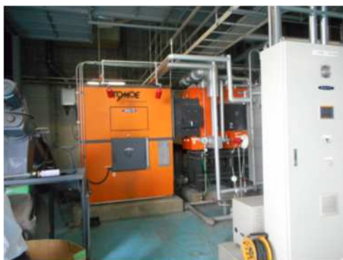
【木質バイオマスチップボイラー】
