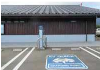
屋久島町役場の普通充電設備 【1台】
