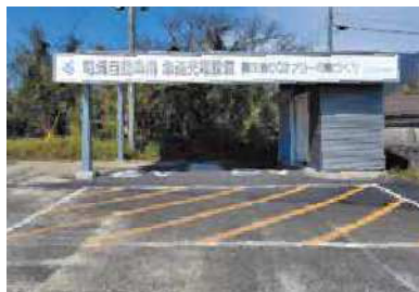
急速充電設備
