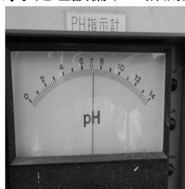
濁水処理設備(PH計測)
