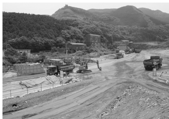
仮設備(電気設備・濁水処理設備・仮沈砂池)
