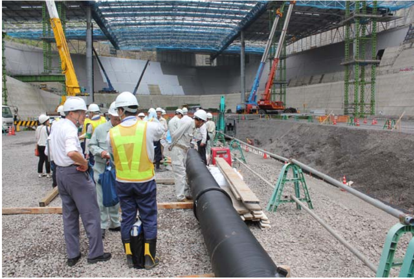
浸出水集排水施設
