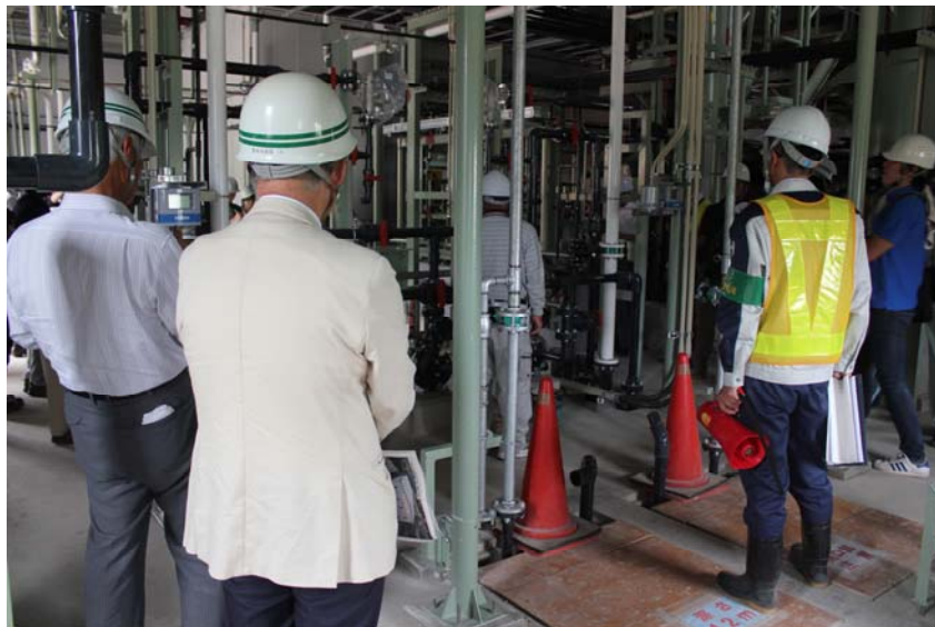
浸出水処理施設
