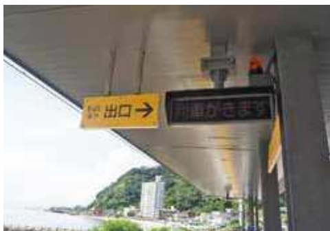
乗降口の頭上に設置された列車接近表示器
