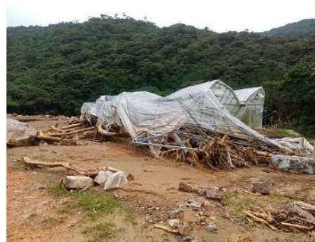
大雨により損壊したハウス
