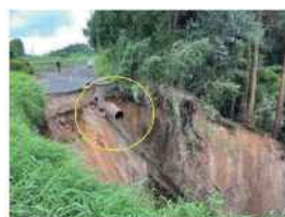
パイプラインの破断
