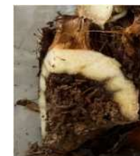
スポンジ状に乾腐 16
