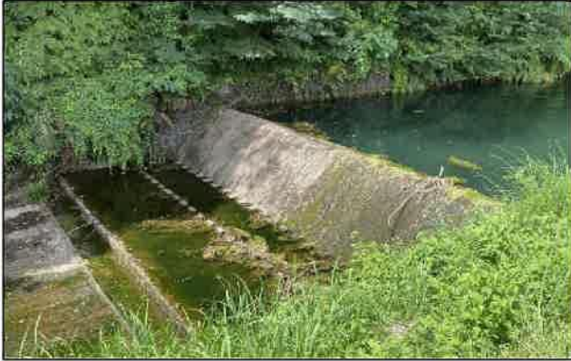
写真1：洪水吐（栗下池）
