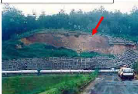
写真 41：堤体付近の法面（崩壊後）
