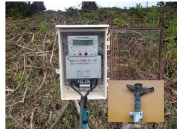
自動散水・止水装置
