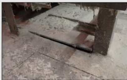
除糞ベルトの床面開口部の蓋の隙間
