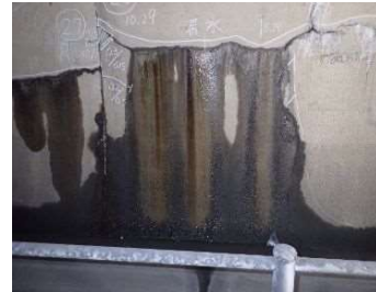
ひび割れからの漏水
