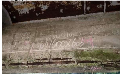
鉄筋露出・破断
