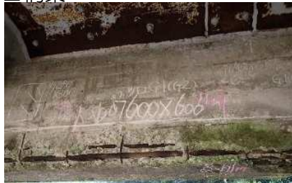
鉄筋露出・破断
