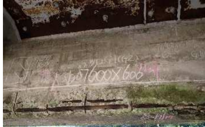
鉄筋露出・破断
