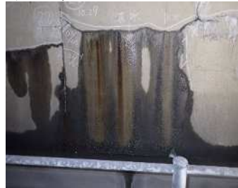
ひび割れからの漏水
