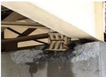
地震（揺れ）による橋梁被害
