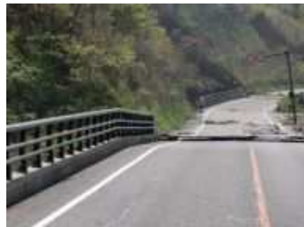
橋梁背面段差（揺れ）
