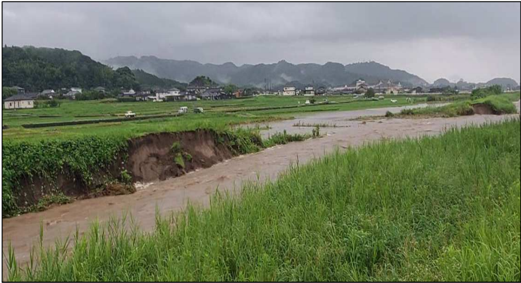
令和4年7月8日～7月20日の豪雨による被災直後 手籠川（霧島市）
