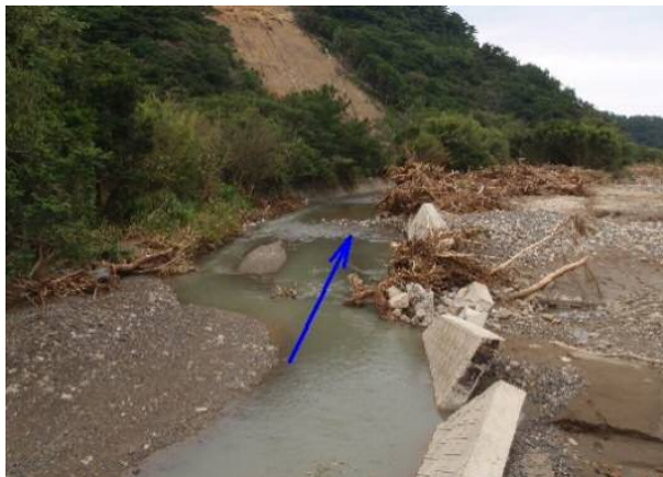
写真 2-1 H23.9 洪水による被災状況 (破堤箇所)
