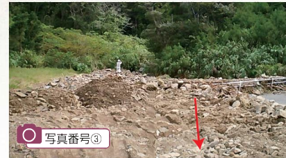
土砂流出状況
