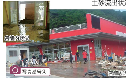
浸水被害状況
