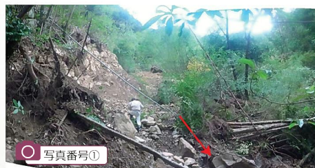
山腹崩壊状況
