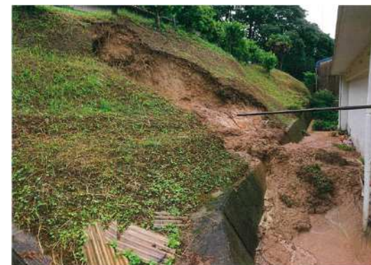
8/17枕崎市 田布川町(がけ崩れ)
