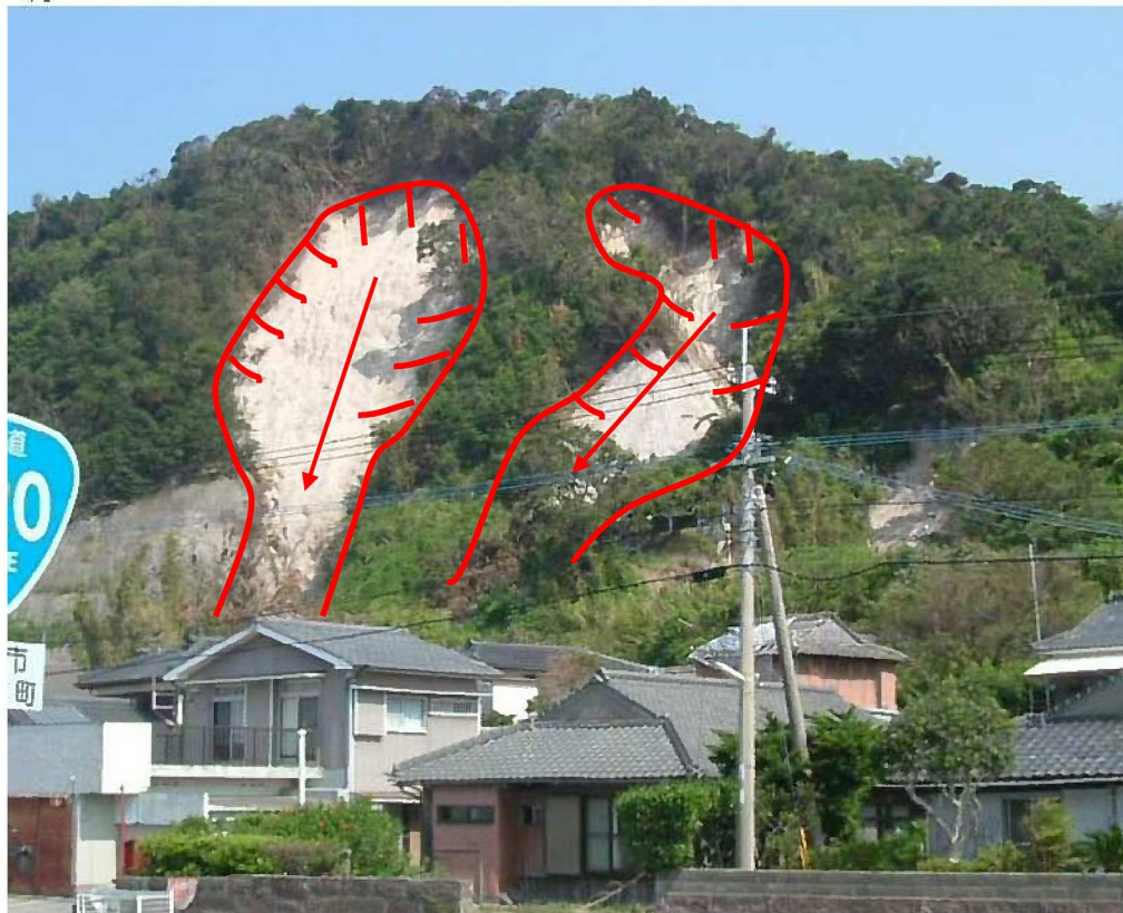
崩壊状況全景
