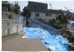
(c)腹付け盛土の崩壊の事例
