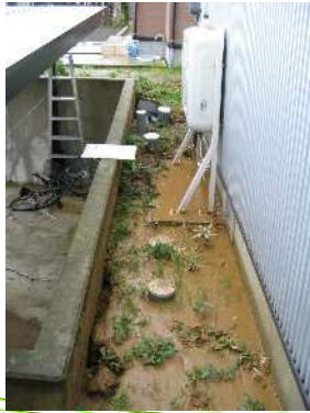
&gt;破裂して水が流出している
