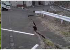
(b)のり尻の亀裂の事例
