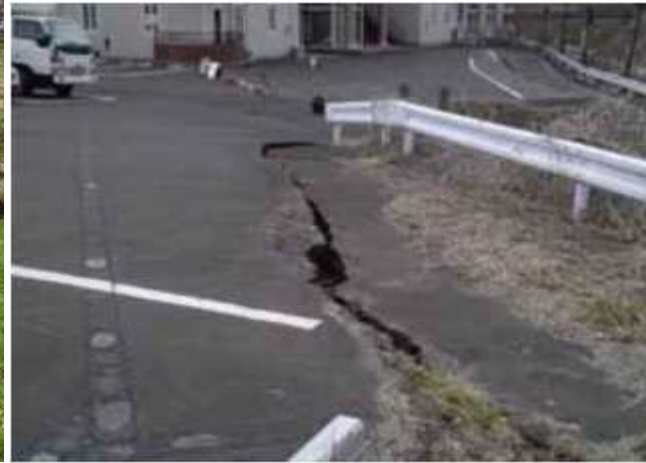
(b)のり肩の亀裂の事例
