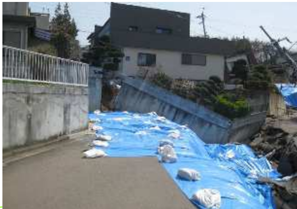
(c)腹付け盛土の崩壊の事例
