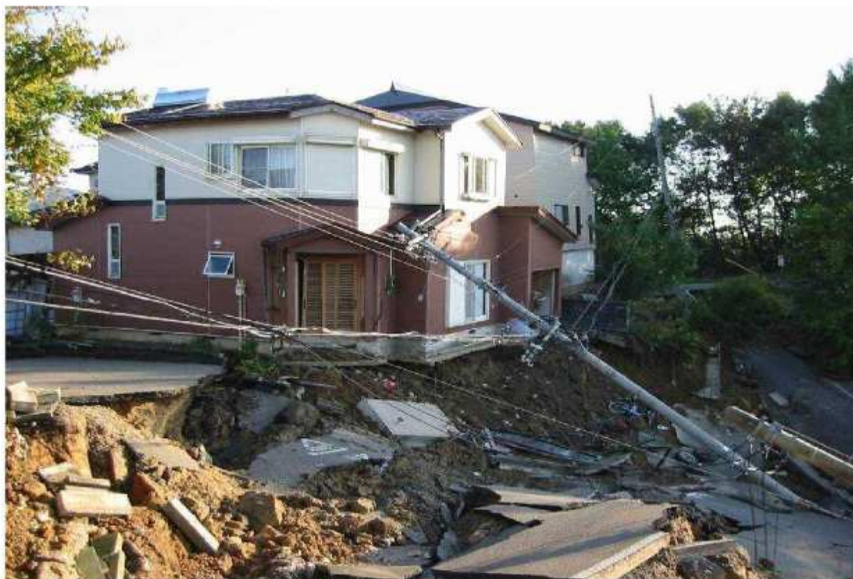
H16新潟県中越地震の被害
