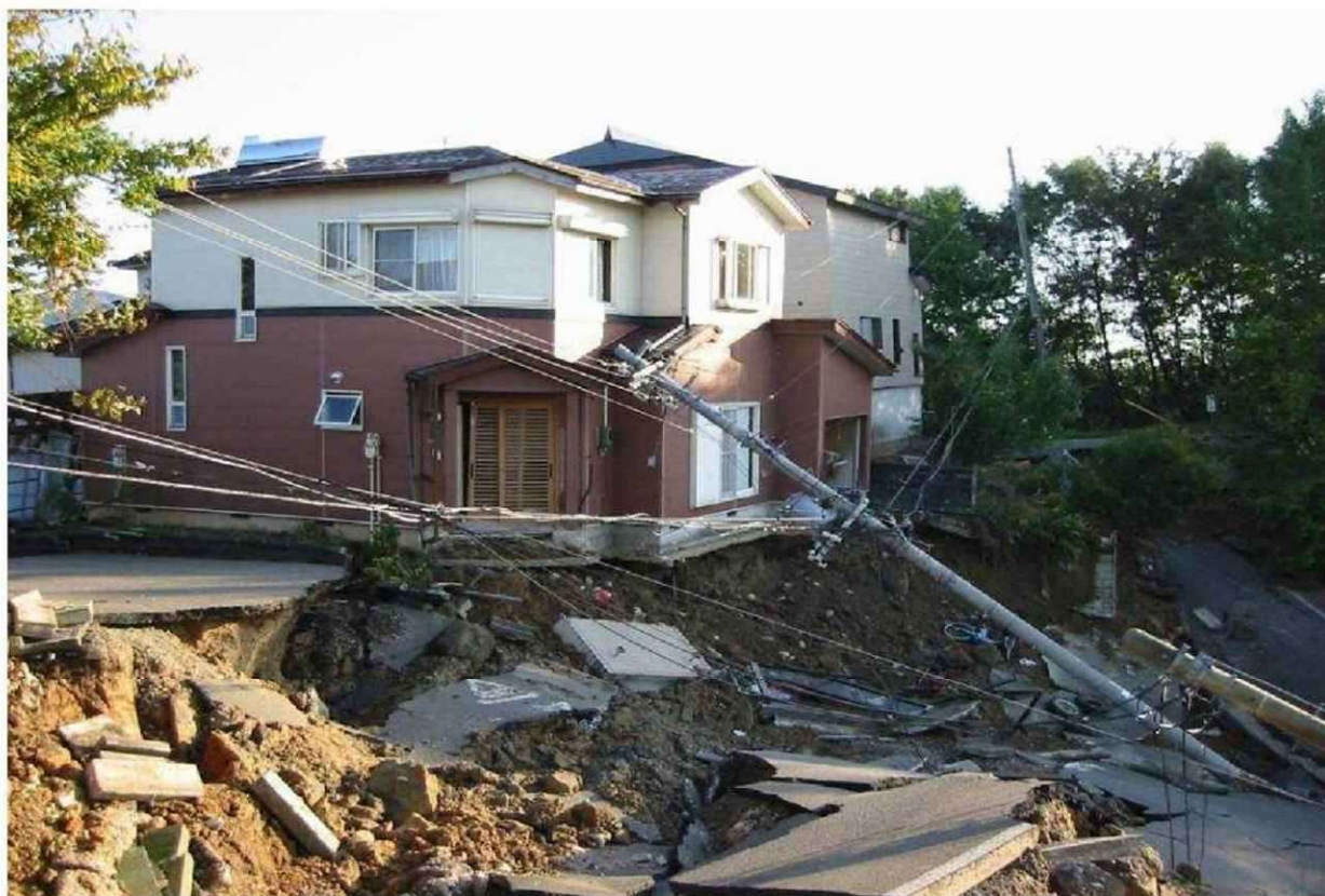
H16新潟県中越地震の被害
