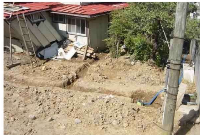
(b) 地震により湧水が出た箇所
